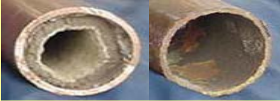
Подающая труба котельной
